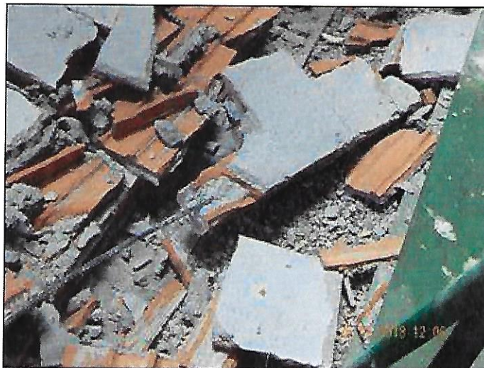
Figura 10. Colapso del muro 2 MEGABRICK 8 (20-50-8)
